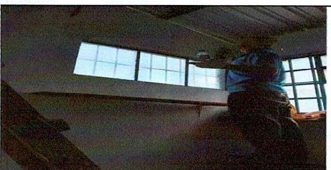
Foto 5: AREA DE COCINA, PAREDES REPELLANDO
